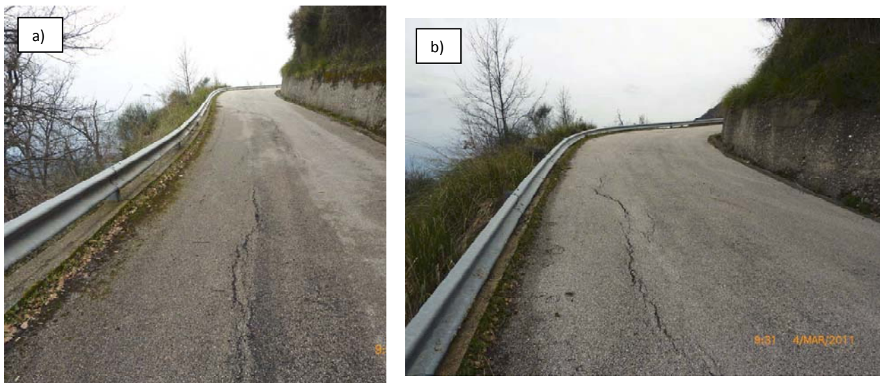
Figura 11: a: Lesione lungo il tratto 3; b: Dettaglio della lesione lungo il tratto 3
