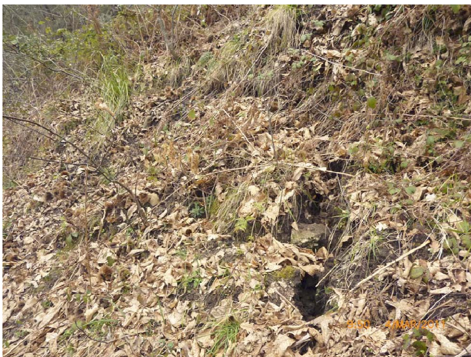
Figura 14: Fratture con beanza e rigetto lungo il versante al piede della frana.
