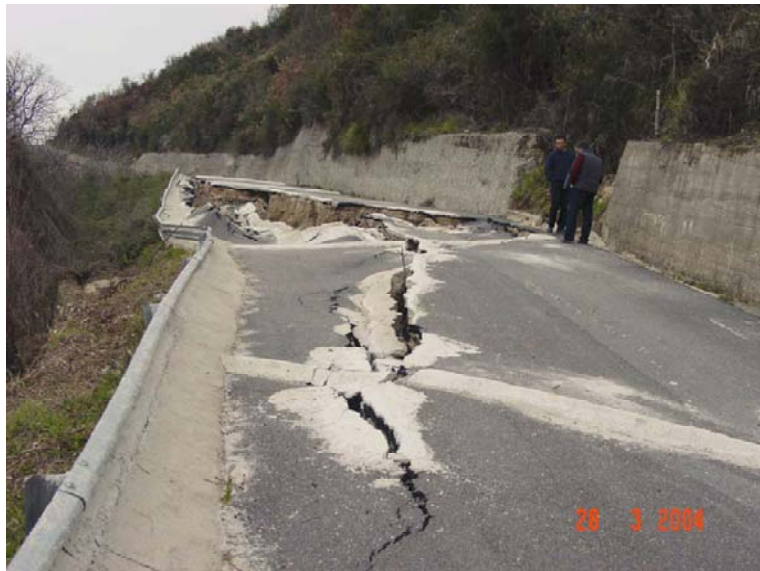
Figura 5: Foto del fenomeno franoso avvenuto nel marzo 2004 e relativi dissesti alla sede stradale.
