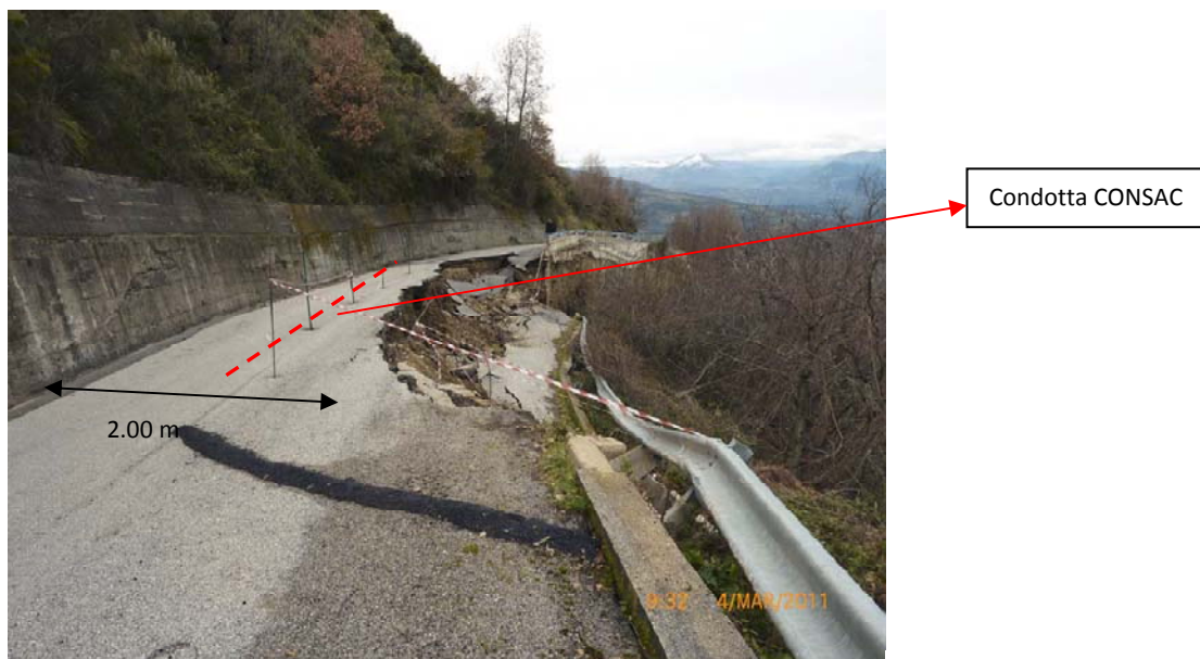
Figura 8: Secondo tratto stradale interessato dalla nuova frana e caratteristiche geometriche.
