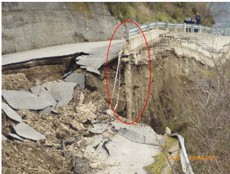
Figura 9: Fianco sinistro della frana con interessamento della estremità occidentale della paratia tirantata.
