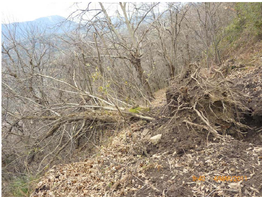
Figura 12: Dissesti al piede dello scorrimento rotazionale, lungo il versante a valle della sede stradale.
