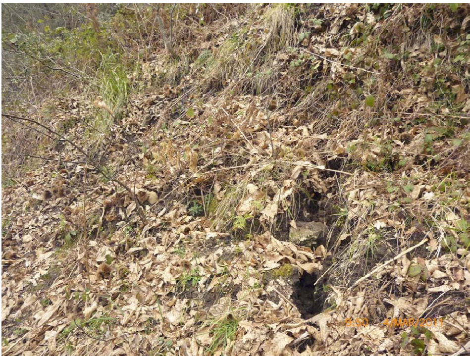
Figura 14: Fratture con beanza e rigetto lungo il versante al piede della frana.
