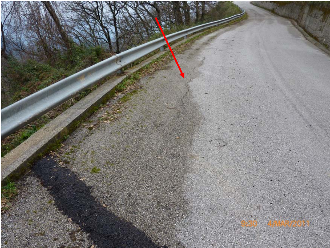
Foto n. 16 (microlesioni sulla strada)
