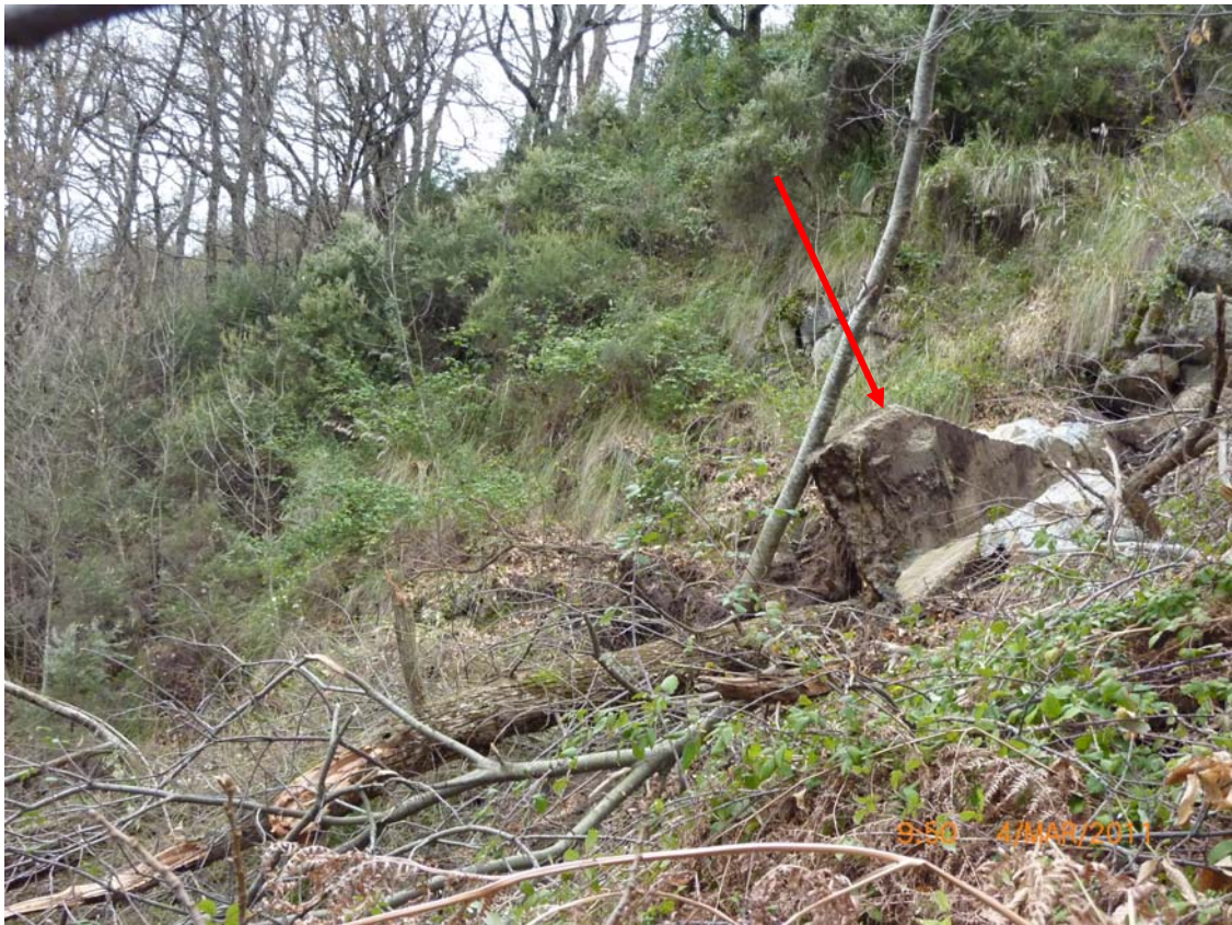
Foto n.07 (contrafforte + alberi crollati)
